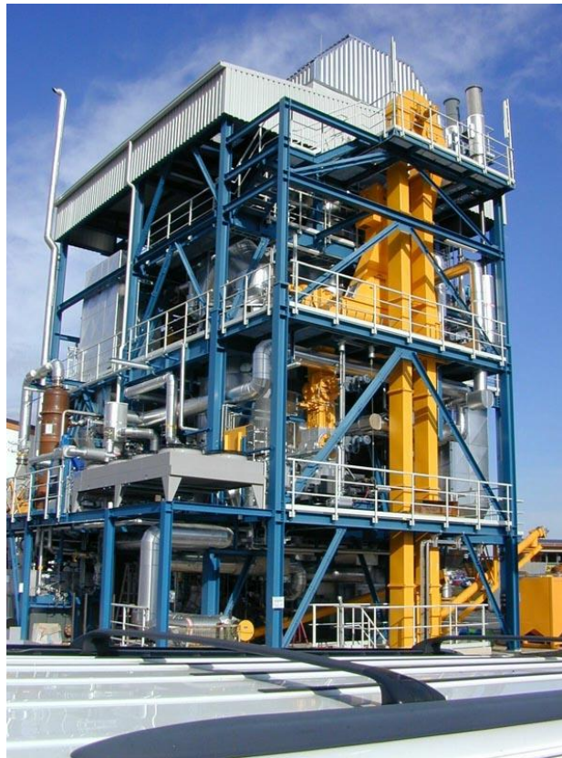
Figura11 . La central de biomasa de Güssing [5]
