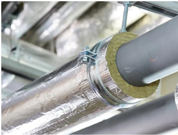
Figura 47 Ejemplo de una tubería de agua caliente en el sistema hidráulico de un edificio
