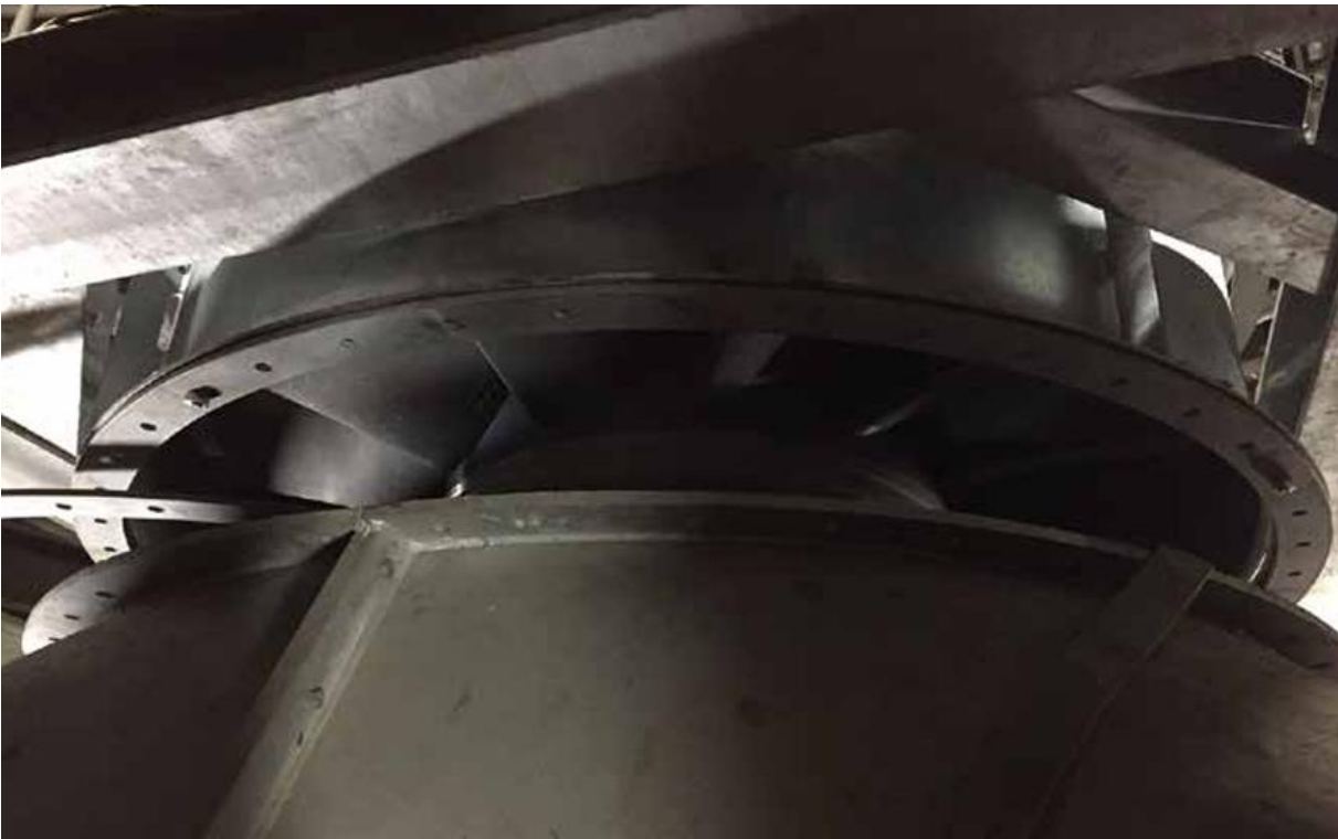
Ventilador de pozo de ventilación
