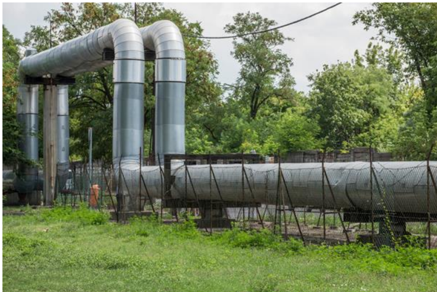
Figura6 . Tuberías de calefacción urbana en superficie (mokshahu)
