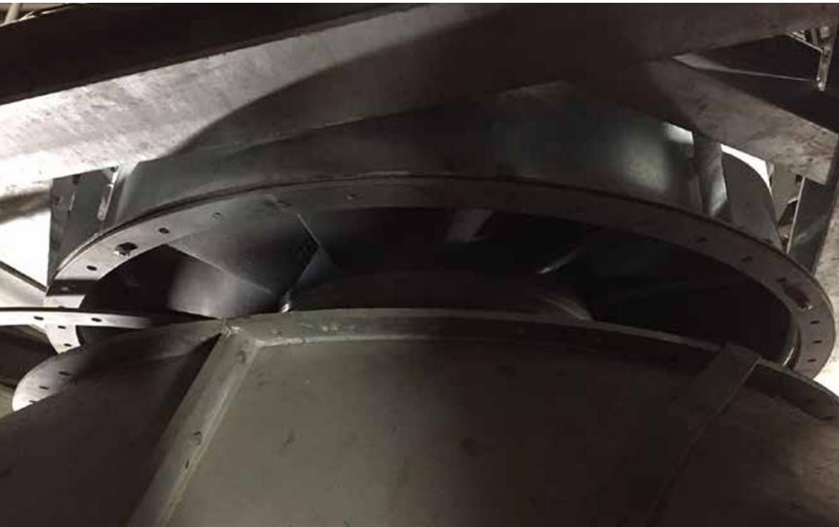
Ventilation shaft fan
